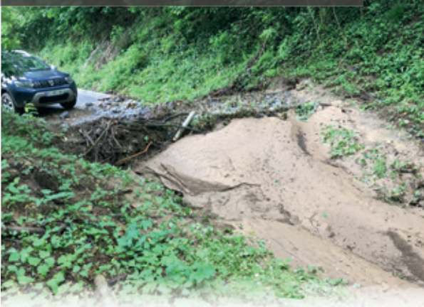
Gabion rempli après le sinistre (Bois Thibaut, Valmondois)
